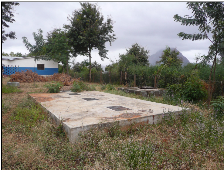
Figura 5.23: pozzi rifiuti liquidi
