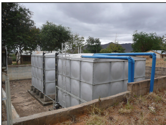
Figura 5.26: serbatoi dell'acqua pompata dai pozzi
